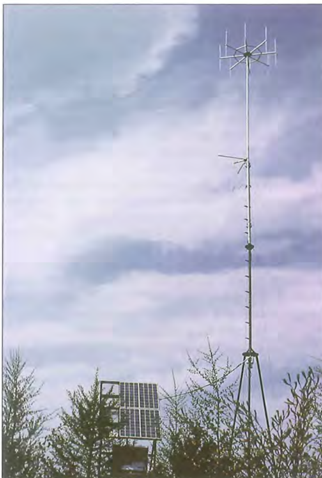
Abb. 12: Telemetrieanlage mit (von oben nach unten): Dopplerantenne, Antenne für Datenfunk, Solarpaneele, Aluschränk mit Dopplerempfänger, Funkmodem, Solarbatterie und Laderegler.
